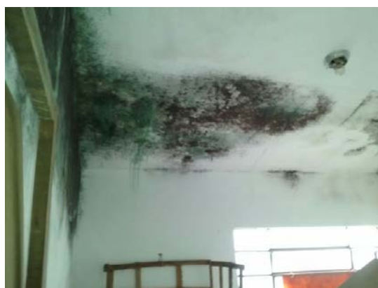
Figuras 3: Presença de mofo em um dos quartos.
